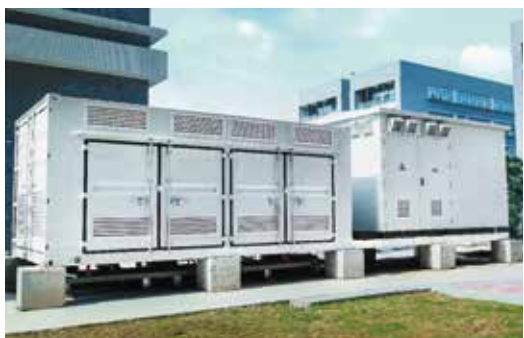
► 江苏盐城某综合国企储能项目
