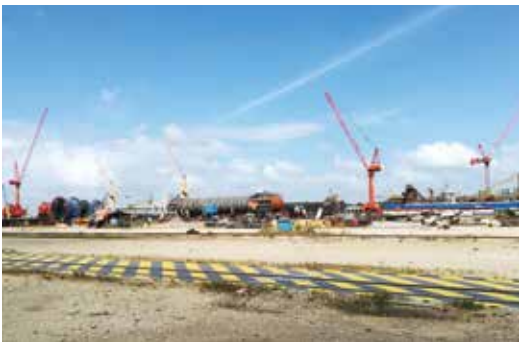
► 中东某地区建筑工地拖挂机临时电源解决方案
