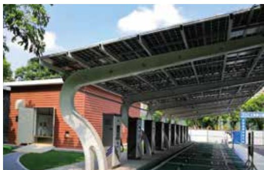
► 广东东莞某光储充检项目
